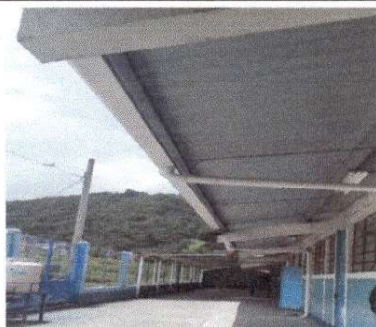
Canales y bajadas de agua
